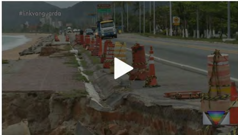
Parte do calçadão da Praia Massaguaçu segue destruída
